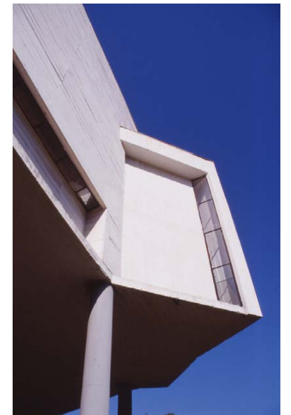
19 detalles de fisura de entradas de luz en zona de Virgen
