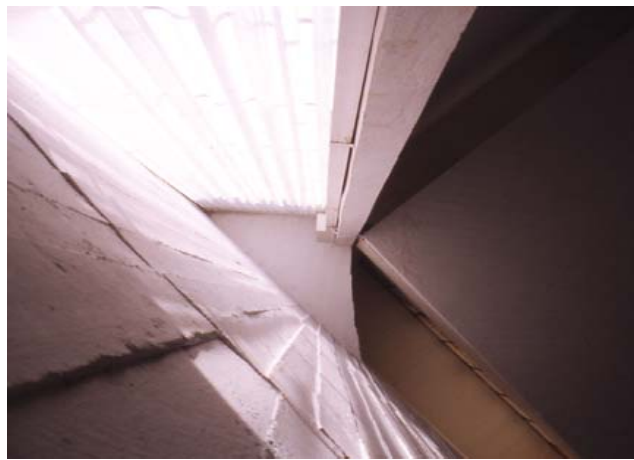
32 Detalle fisura vertical en zona de altar, el moldaje apoya el drama de la luz.
